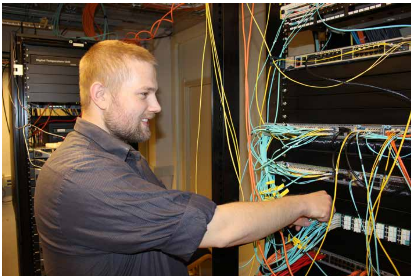
Kim Eirik Kvasheim sjekker kablingen/inspecting cables
